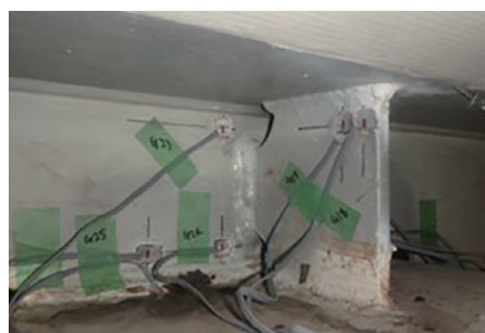
鋼桁の応力モニタリング
